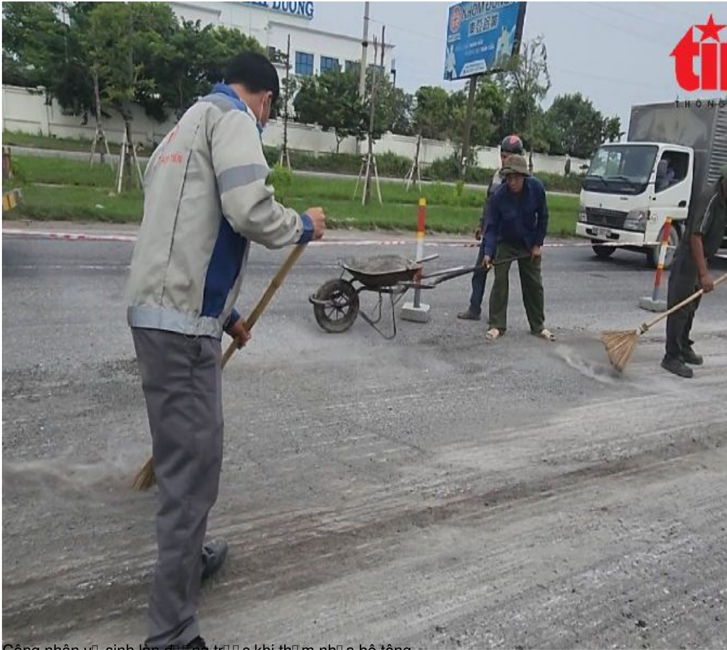
Công nhân vệ sinh làn đường trước khi thi công nhả bê tông.
