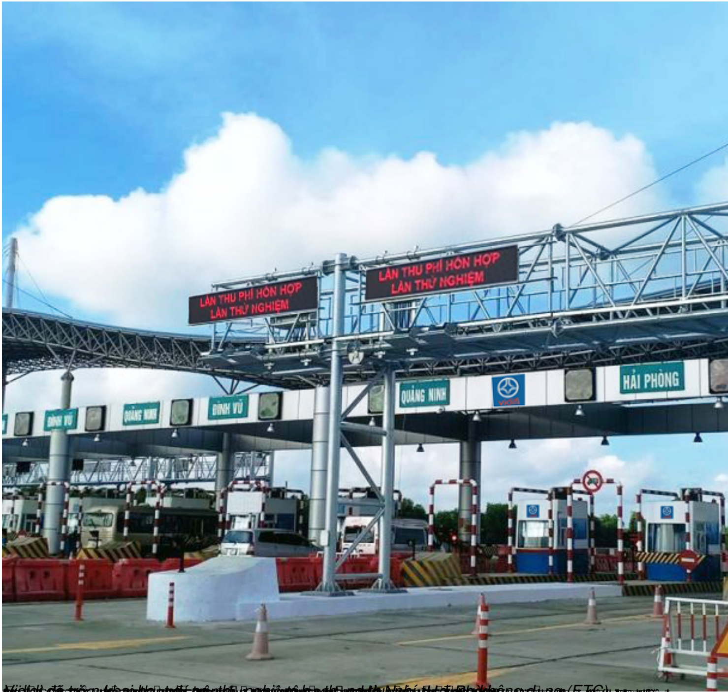
Khi bắt đầu thu phí thí điểm trên tuyến cao tốc Hà Nội - Hải Phòng, đơn vị thu phí đã lắp đặt hệ thống thu phí không dùng (ETC) và chuẩn bị công nhân hướng dẫn giao thông tại các làn thu phí.
