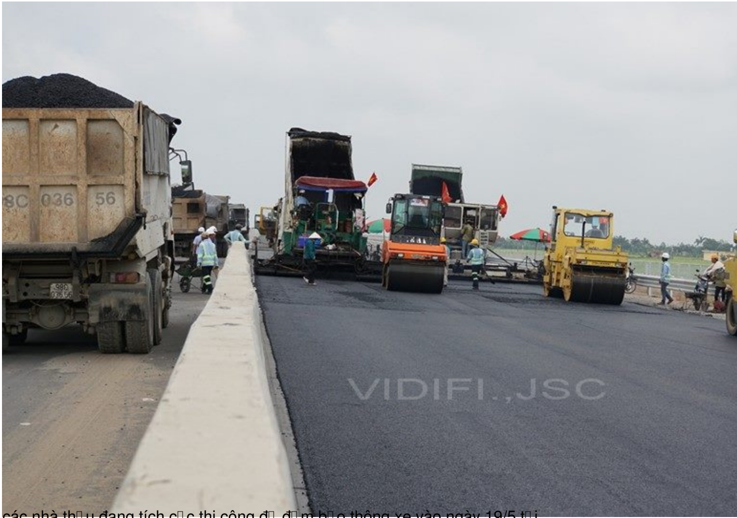
các nhà thầu đang tích cực thi công để đảm bảo thông xe vào ngày 19/5 tới
