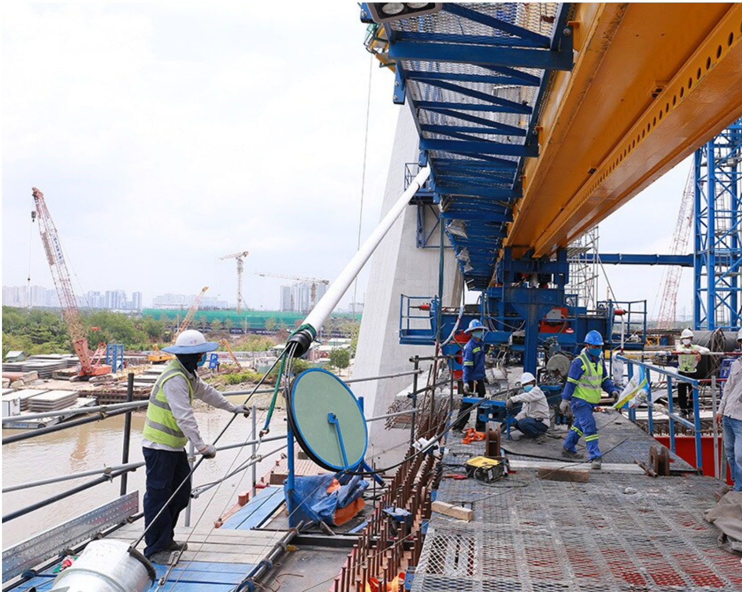
Công nhân thi công bó cáp d ưu tiên c a c u Th Thêm 2
